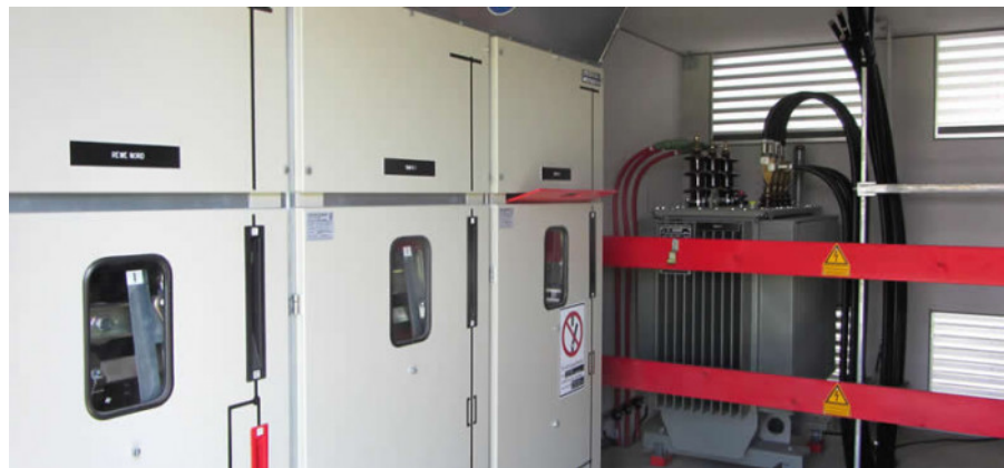
Innenansicht einer Trafostation des Blockheizkraftwerks (Bildquelle: EHA)
